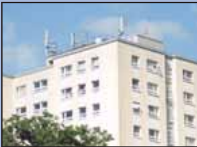
Размещаемое на крыше типовое телекоммуникационное оборудование
