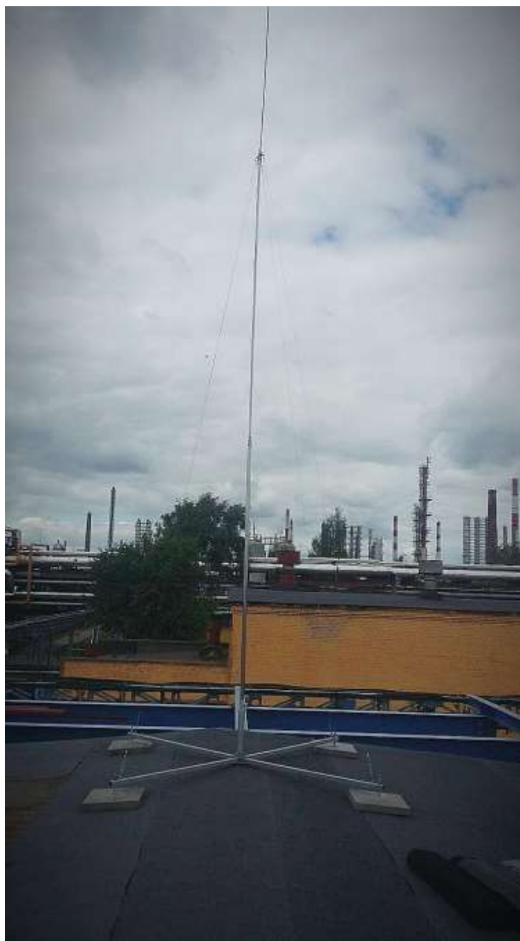
Рисунок 2. Молниеприемник на бетонном основании высотой 8 метров
