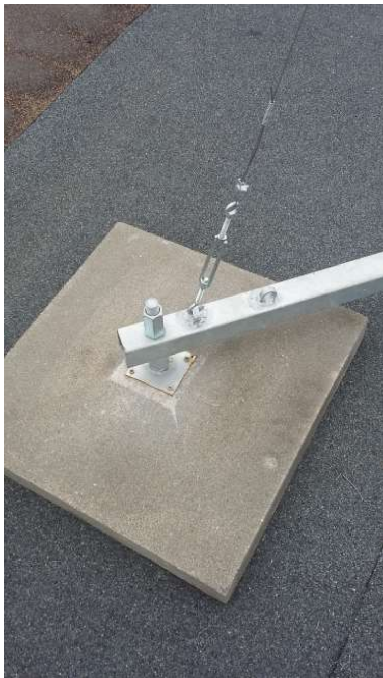
Рисунок 1. Бетонное основание молниеприемника
